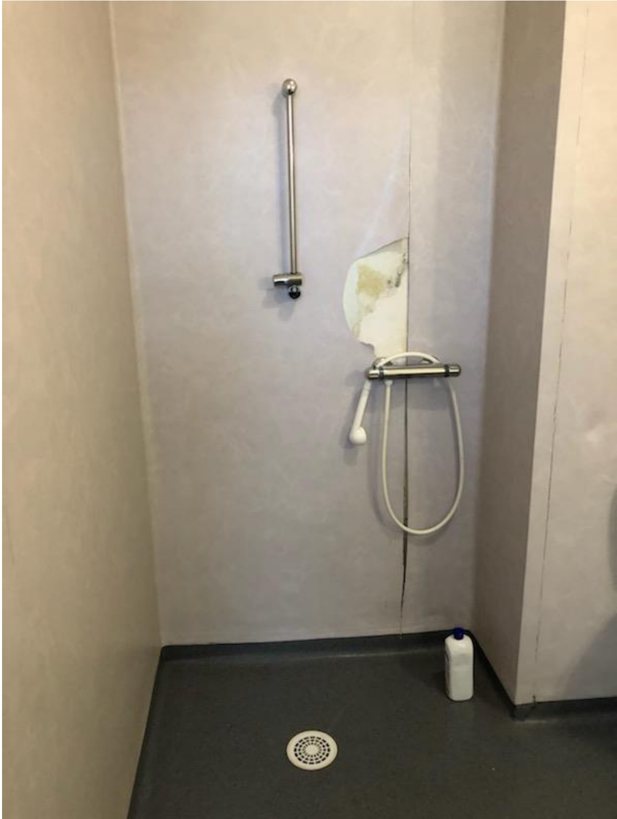
Salle de douche attenante à une chambre normale (Bâtiment Stanislas Tomkiewicz (USIP))
