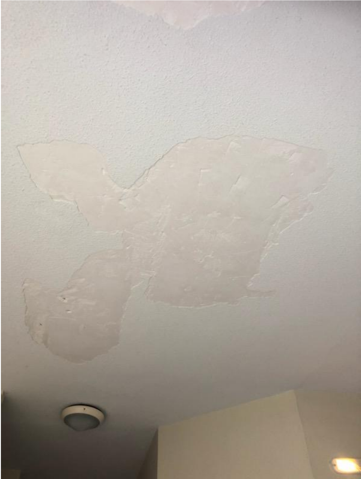
Chambre normale – état du plafond (Bâtiment Stanislas Tomkiewicz (USIP))
